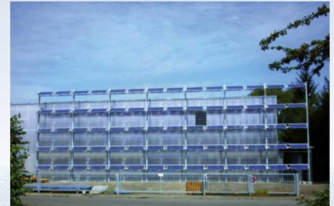
Solaranlage an der Südfassade des ISC Konstanz Gebäudes
