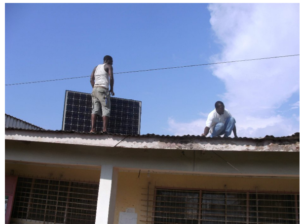
(Bild links und rechts): Aufbau der Solar-Module im Solardorf und in der Solarschule, Kamerun
